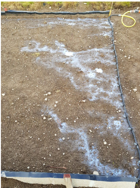
Figur 7: Overflateavrenning i kontrollruta. Denne avrenningen infiltrerte etter hvert, men ble samlet opp i rennene i enden av vegetasjonssonen.
