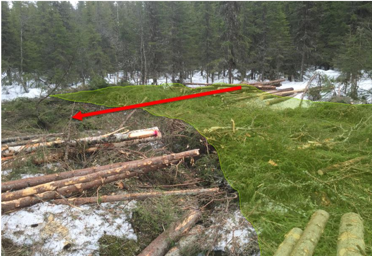
Figur 25. Det grønne området viser bæresvak mark inntil en sumpskog. Dette området tåler vekten av hogstmaskinen, men ikke lastetraktoren. Virket legges ut til venstre (rød pil) og inn på bæresterk mark som tåler lastetraktoren. Det opparbeidete virket opp til høyre i bildet, er i dette tilfellet lagt utilgjengelig for lastetraktoren og dermed feilplassert.
