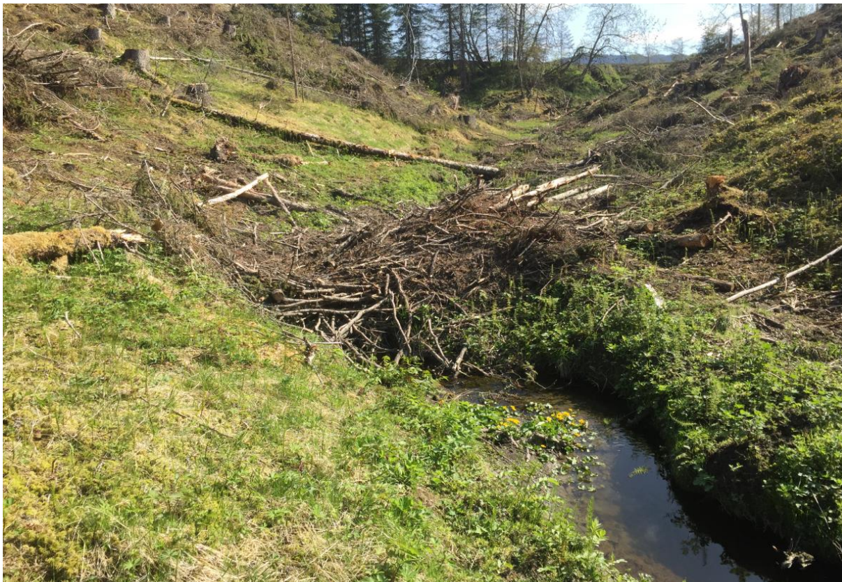
Figur 16. Liten bekk med årsikker vannføring som er fylt med kvist etter drift. Dette er forbudt i henhold til både vannressurslov og bærekraftforskrift, og skal fjernes. Ofte skjer dette vinterstid når bekken er vanskelig å se. Bruk av markfuktighetskart vil være til hjelp i slike situasjoner.
