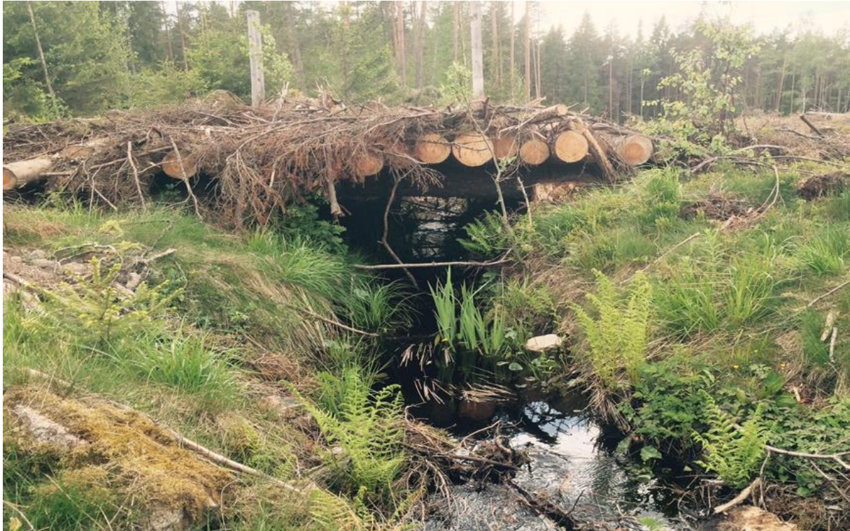
Figur 19. Ferdig bru. Kravet for bruk av skogfond, er at den fjernes etter bruk. Da er det viktig å tenke gjennom om det er andre maskiner som skal inn etter at drifta er avsluttet, f.eks. markbereder, sporoppretter, grøfteutstyr osv. Brua bør ligge inntil slike arbeider er avsluttet.
